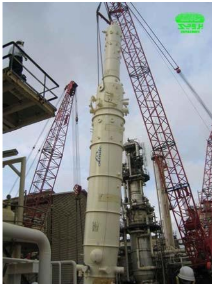
Un tipico MCHE di recente costruzione, installato in Brunei. Fonte: www.blng.com.bn
